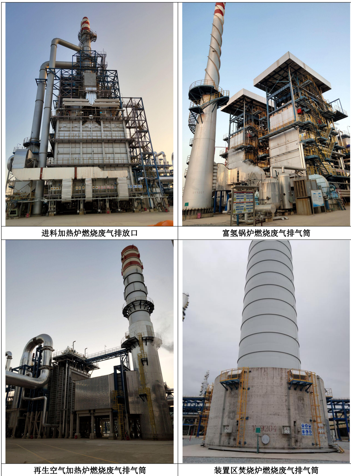
图 4.1-17 废气排气筒现场图
