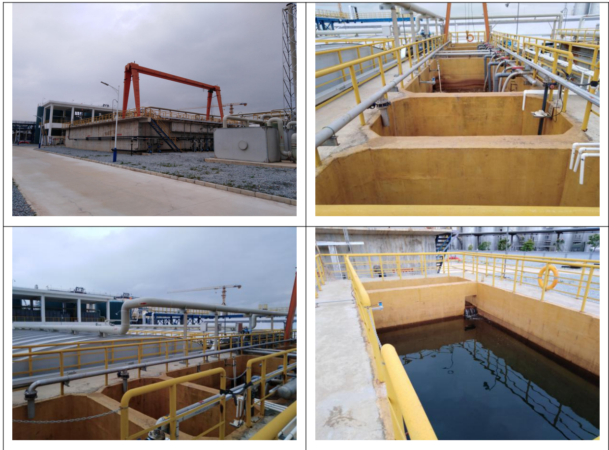
图 4.1-11 一期工程及其配套项目污水处理站现场照片
