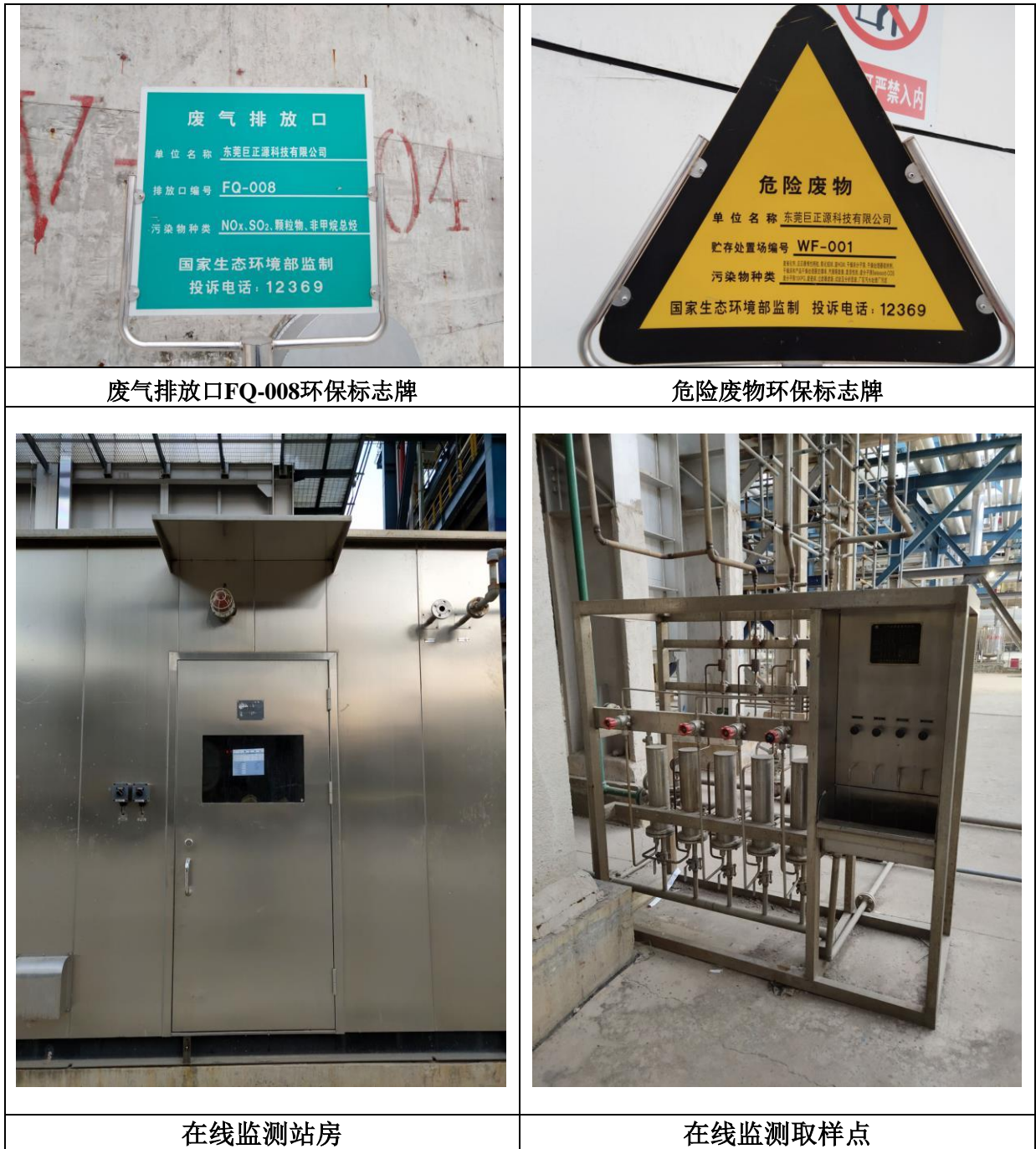
图4.2-2 一期工程部分环保标志牌及在线监测设备设置情况
