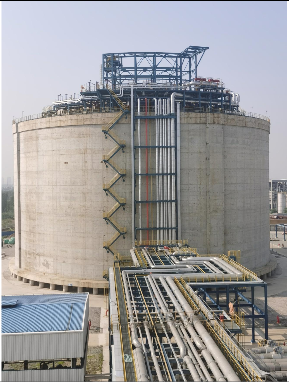
本项目低温丙烷罐
